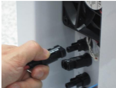
PV Steckerverbindung (MC4 Steckerverbindung)
