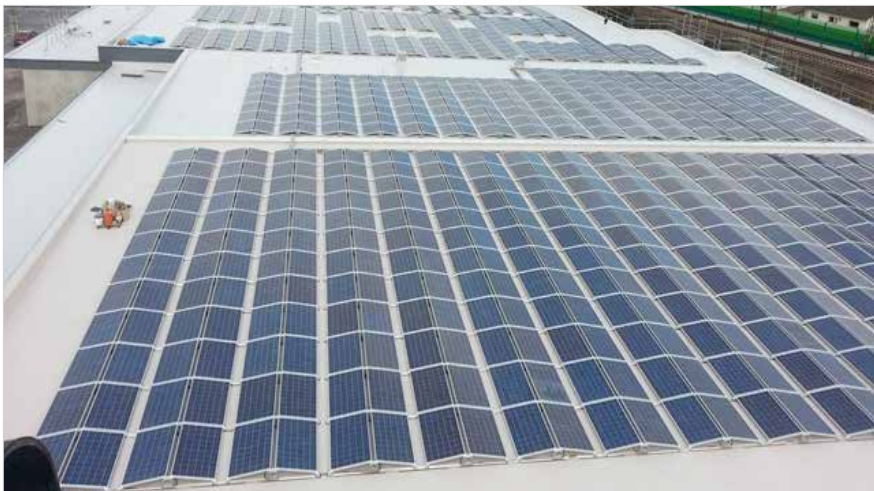
Hemsbach | Deutschland Anlage: 350 kW | D-Dome System
