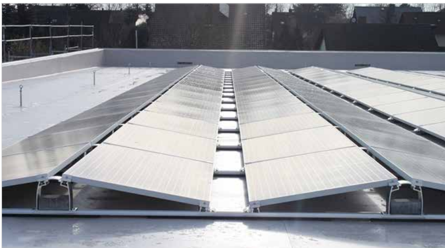
Hemsbach | Deutschland Anlage: 350 kW | D-Dome System
